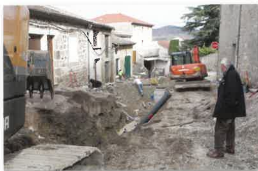
Réseaux des eaux pluviales
