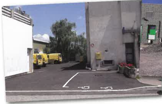
Aménagement et étanchéité du parking de La Poste et création d'une place PMR devant l'entrée
